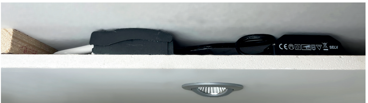
6 - Das Ergebnis: eine kompakte Installation mit einem schwenkbaren Spot, einem dimmbaren Netzgerät sowie der Möglichkeit zur Durchgangsverdrahtung im Deckenhohlraum – ideal im Sanierungsbereich.
